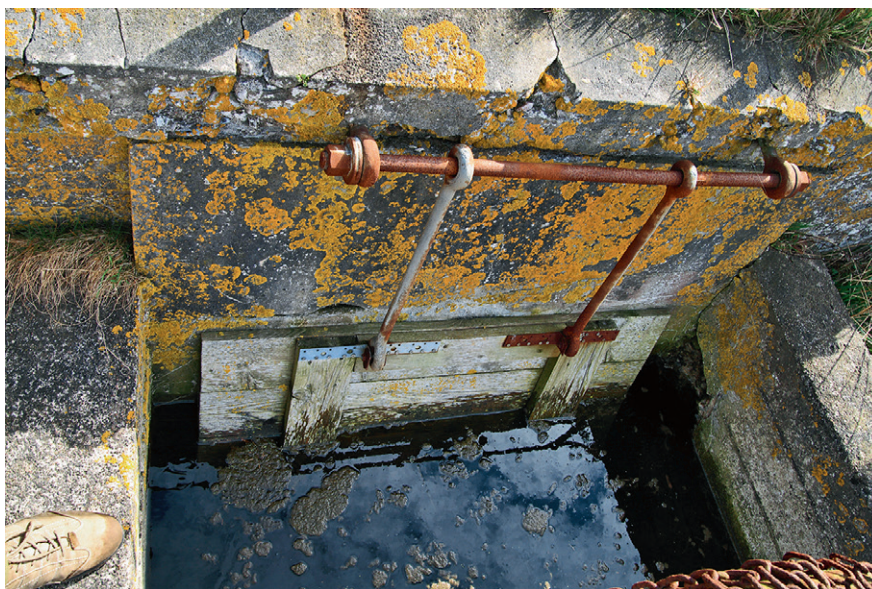
Denne nedslidte højvandssluse i vejdæmningen regulerer udstrømningen af vand fra Gardersø og forhindrer, at der trænger saltvand op i kanalen fra Føns Vig.
