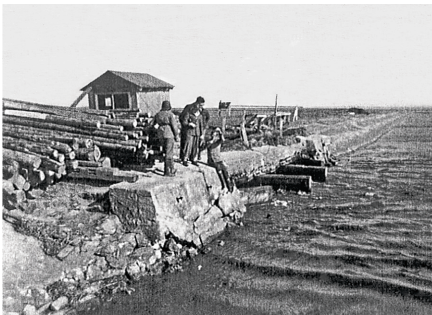
Den første sluse i Attrup-Øland-dæmningen var ikke det store kunstværk og ej heller særlig teknologisk avanceret. Hvornår billedet er fra, kan ikke afgøres, men formentlig er det taget en del år efter opførelsen, da slusen er præget af et betydeligt forfald. Foto: Privateje.
