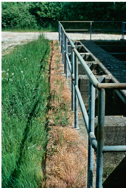
Der skal se pænt ud ved pumpestationen, også selvom det kræver en omgang med et kemisk ukrudtsmiddel.
