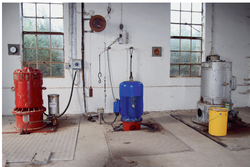
Udover de oprindelige pumper findes flere generationer i pumpehuset. Den grå »Lykkegaard«-pumpe til højre er fra 1978, mens de to andre er af nyere dato.
