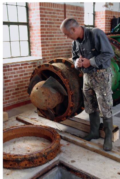
Efter 28 års pålideligt arbejde skulle Billitse pumperne have et eftersyn i september 2010, og når man overværer et sådan servicetjek, forstår man bedre, at der altid skal være højt til loftet i et pumpehus.
