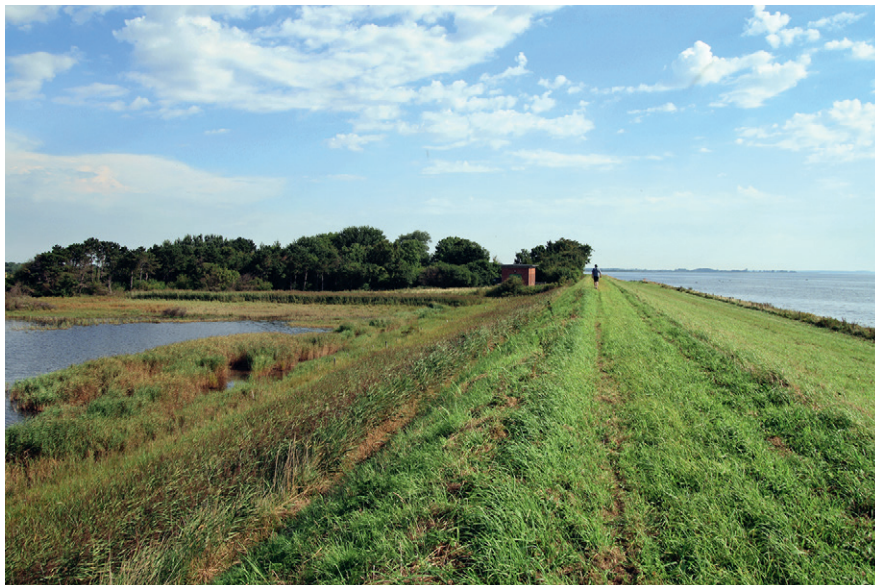
Pumpehuset ved Billitse ligger nogenlunde der, hvor Lollands-diget ramte fastlandet ude fra Brunddragene i 1875. Til højre ligger Østersøen og til venstre aner man Fugleværnsfondens vådområde.
