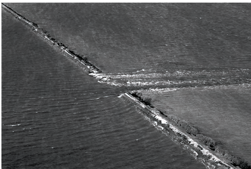
Arup-dæmningen blev gennembrudt så sent som i januar 1984, hvor 60 meter blev skyllet væk. Reparationen kostede 2,5 mio. kr. (4,7 mio. kr. i 2009-værdi). Staten betalte halvdelen, mens resten blev delt mellem amt og kommune. Foto: Lokalthistorisk Forening for Sydhavnæs.
